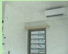
冷暖房完備 空調設備齊全
